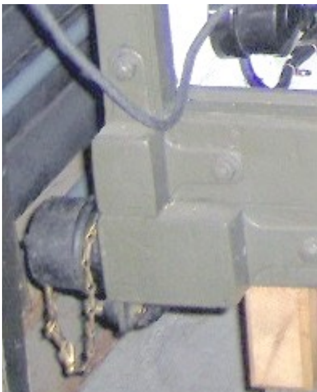
Stromanschluss Kabine (Foto 5)
