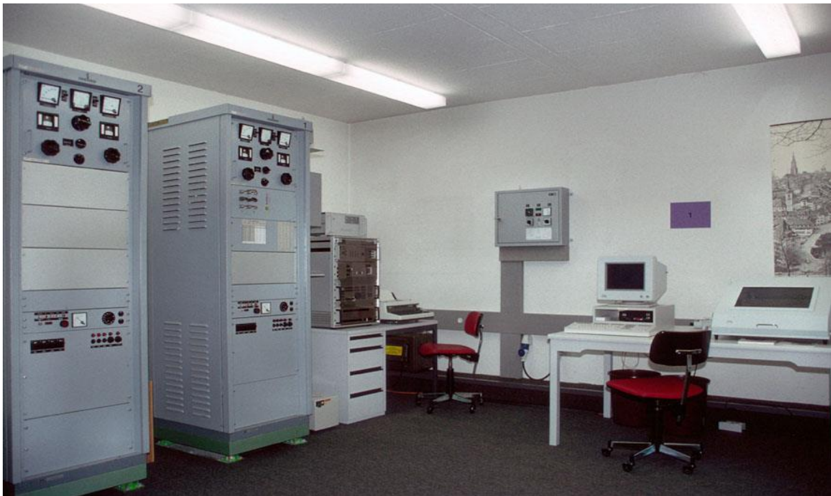
Die ARQ Ausbildungsstation „Schwere Funkfernsehstation SF“ mit den 2 modifizierten 1 kW-Sendeleistungsverstärker ( PA ) von SIEMENS und dem Chiffriergerät TC-91 (rechts).
